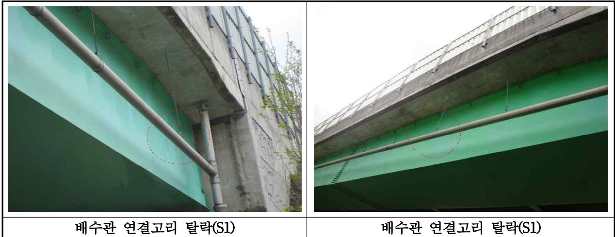
【사진 3.3.21】 배수시설 손상현황(부산)
