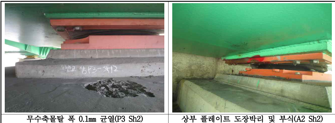
【사진 3.2.13】 교량받침 손상현황(대구)
