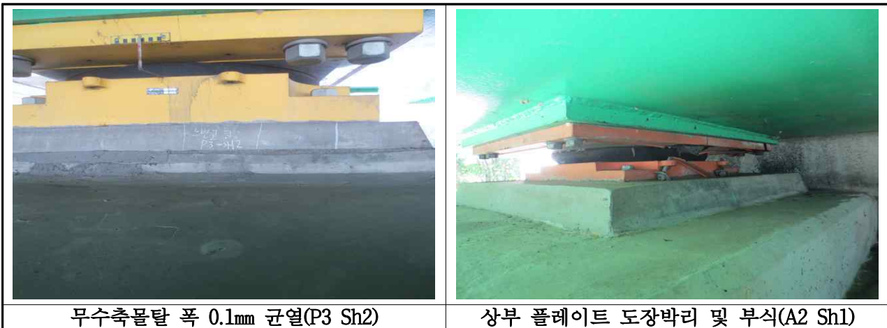
【사진 3.3.13】 교량받침 손상현황(부산)
