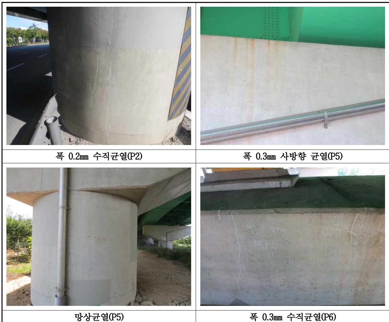
【사진 3.3.11】 교각 손상현황(부산)
