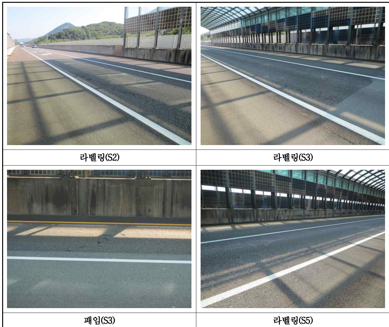
【사진 3.2.19】 교면포장 손상현황(대구)
