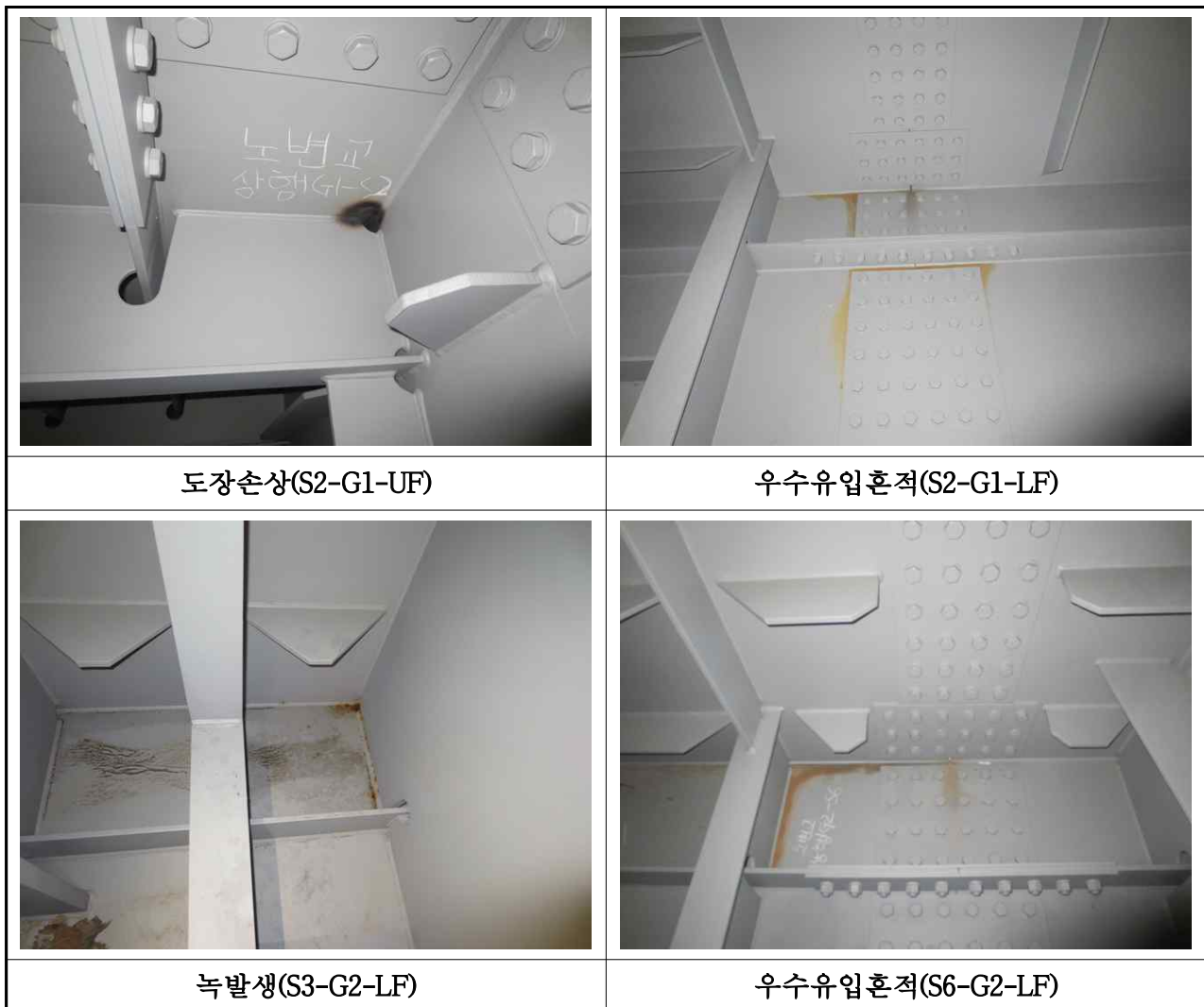
【사진 3.2.4】 강박스 거더 내부 손상현황(대구)
