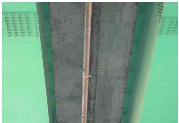
배수관 연결고리 탈락(S7)
