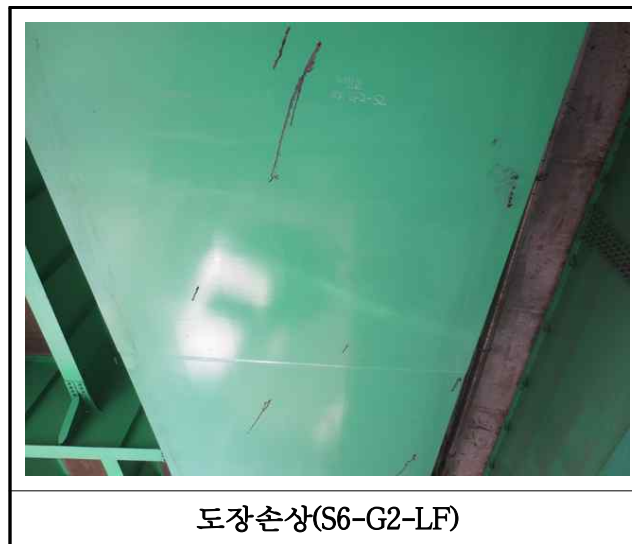
【사진 3.3.5】 강박스 거더 외부 손상현황(부산)
