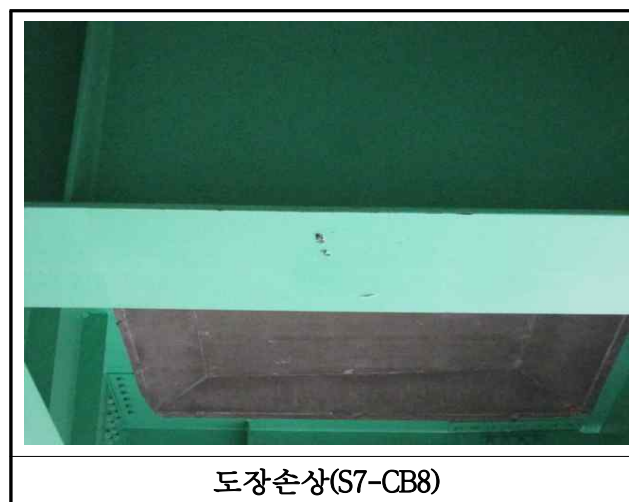
【사진 3.3.7】 가로보 및 세로보 손상현황(부산)
