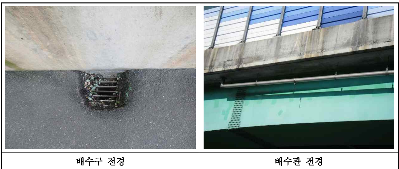
【사진 3.3.20】 배수구 및 배수관 전경(부산)
