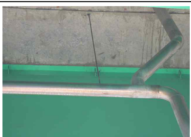
배수관 연결고리 탈락(S4)
